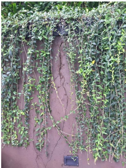
Gambar 2. Keretakan Pada Dinding Kolam Renang
